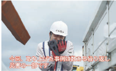
ハッチ開口部が開きっぱなしになっており、作業員が気づかず通行してしまい
